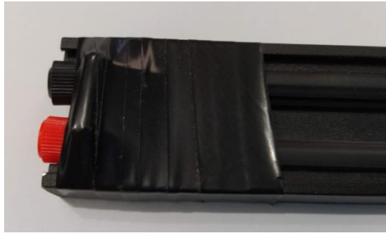
Figura 3: Detalhe dos bornes isolados por fita isolante.
